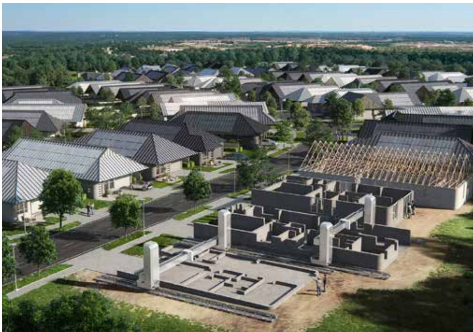
▼ El barrio de cien viviendas de Georgetown, en Estados Unidos, en proceso, es el mayor proyecto de construcción en 3D automatizado del mundo.
